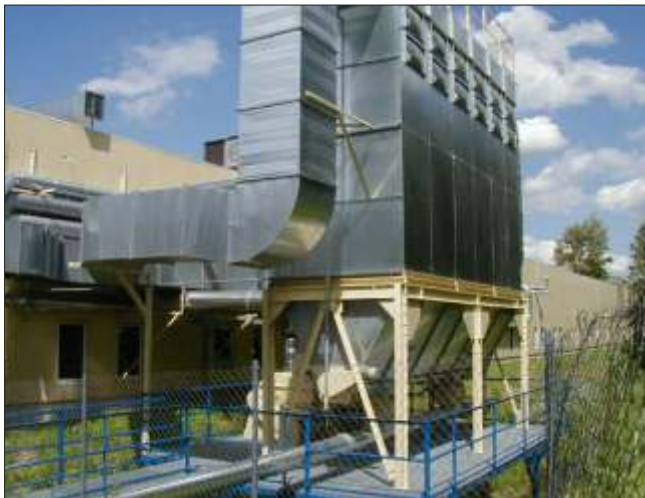
• Filtr FZŠ-PJ-45-D-6 instalovaný ve firm Sapeli s.r.o. (Polná, R)
